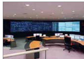
電力系統監視制御システム
