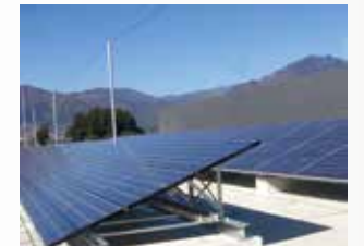
太陽光発電システム
