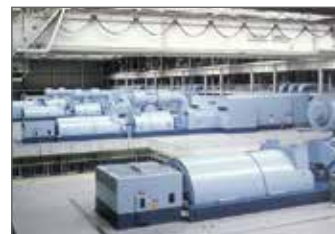
タービン発電機
