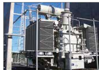
特別高圧変圧器 (2MVA以上)
