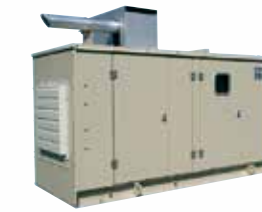
非常用発電設備
