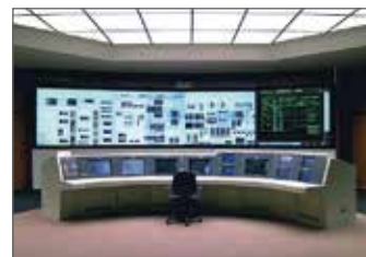
発電プラント計装制御システム
